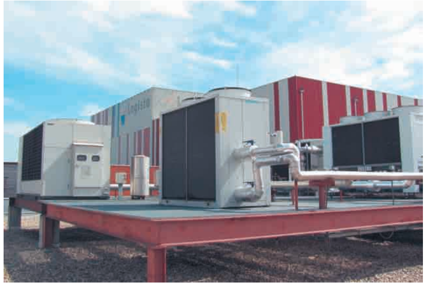
Foto A1.1. Sistema de climatización en centro logístico de la Comunidad de Madrid. Fuente: Geoter.
