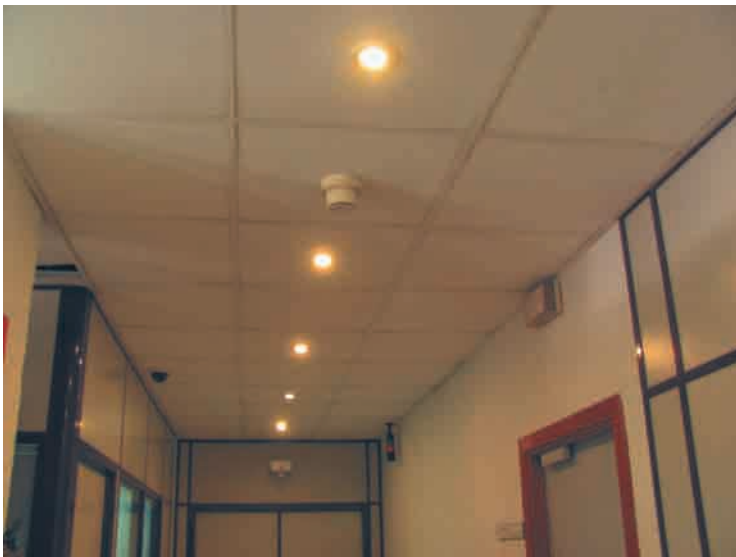
Foto 3.5. Sistema de iluminación en zonas comunes de oficinas de un centro logístico. Fuente: Geoter.
