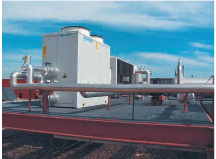
Foto 3.3. Instalación térmica de distribución en cubierta. Fuente: Geoter.
