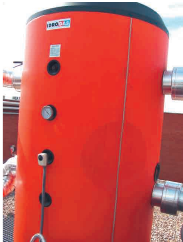
Foto 4.5. Depósito de inercia para centro logístico de la Comunidad de Madrid. Fuente: Geoter.
