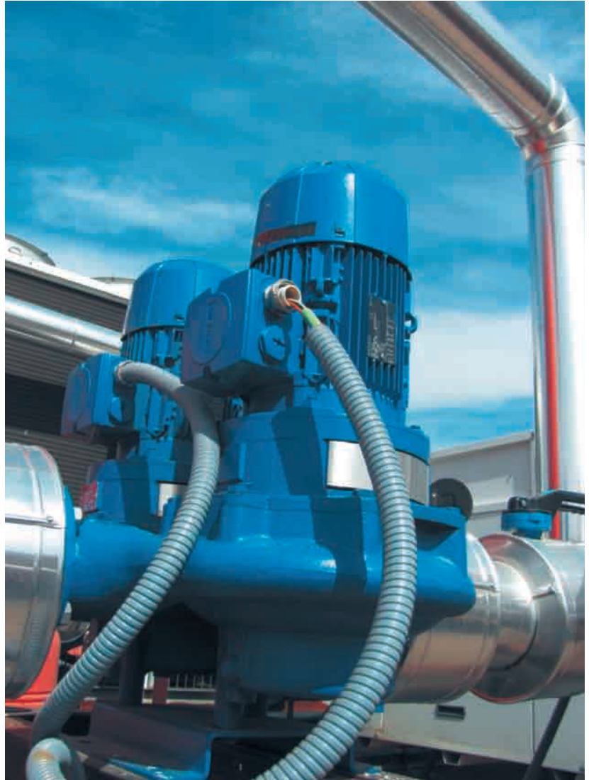
Foto 4.4. Bombas gemelas de bombeo de climatización para centro logístico de la Comunidad de Madrid. Fuente: Geoter.
