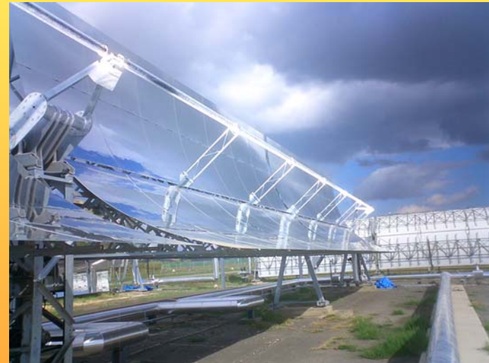
Campo solar en operación
