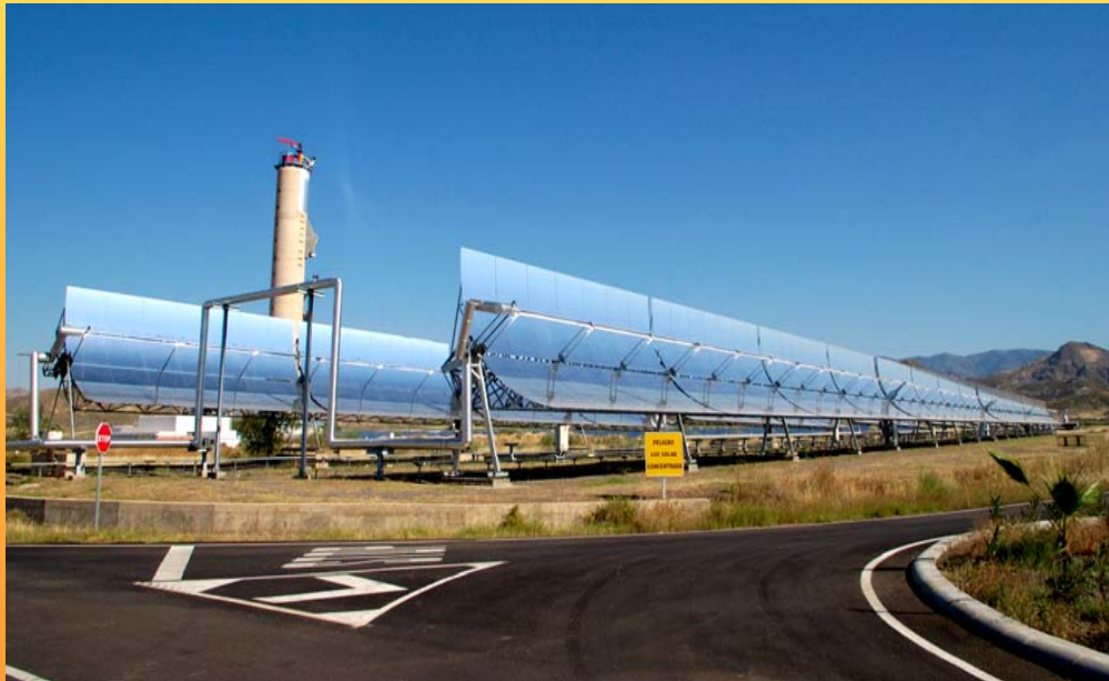
Vista del extremo Sur del campo solar
