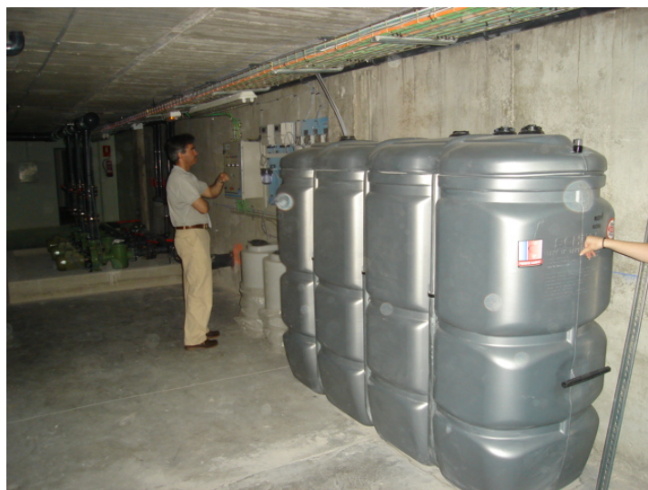
Figura 54: Equipos de depuración de piscina.
