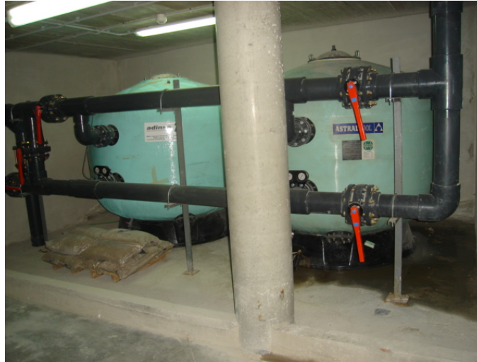
Figura 55: Filtros de piscinas marca ASTRAPOOL.
